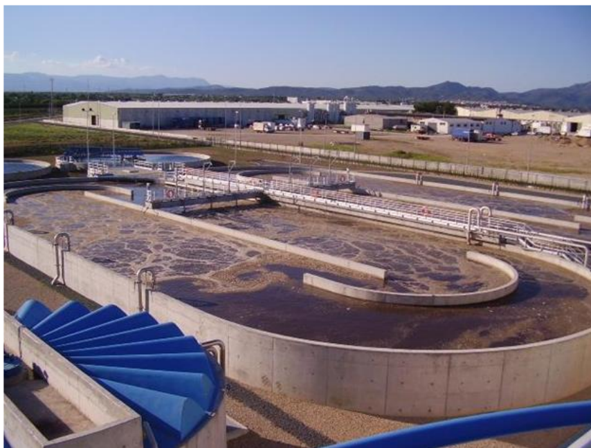
Fig. 1 Vista del reactor biológico de la EDAR de Vinaròs. (Fuente: EPSAR Entitat de Sanejament d'Aigües)
